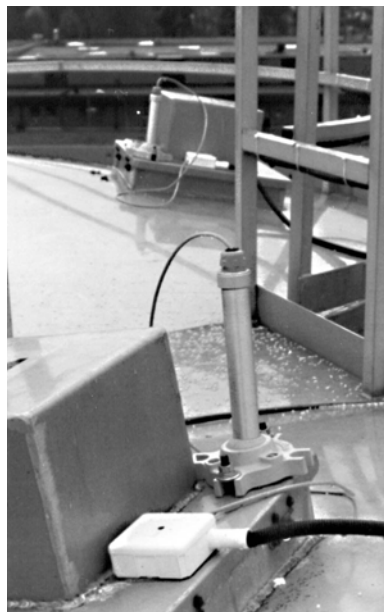
Érzékelő elhelyezése műanyag granulátumot tároló siló tetején
